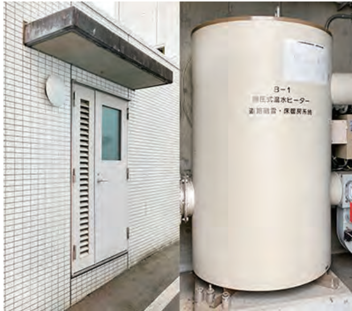
▲床暖房用のボイラー
